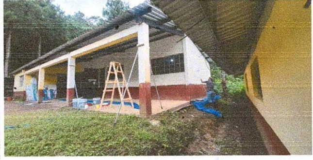
Foto 2: aplicación de pintura en paredes exteriores e interiores de aulas del modulo numero 1,
